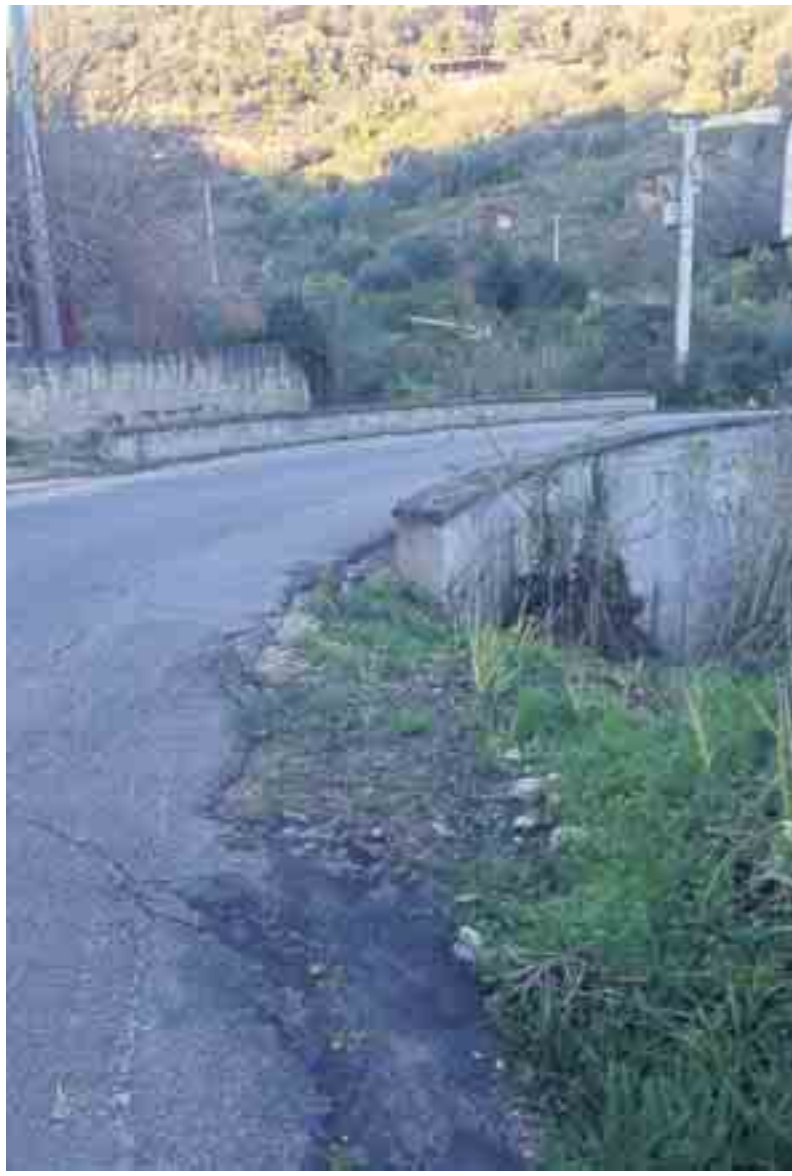
Il pericolo Viabilità cilentana al collasso: rischio smottamenti dopo le piogge
